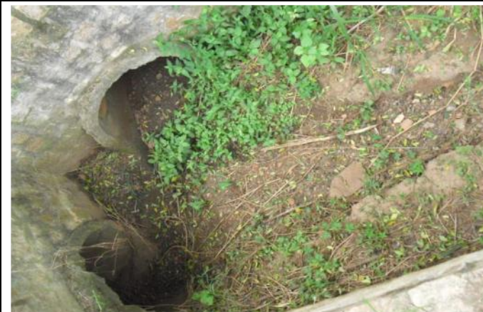
Foto 60: Ponto de lançamento de galeria de águas pluviais. Identificado assoreamento das tubulações. Local: Endereço: Rua José Picchi. Coordenadas Geográficas: UTM 7.418.155 S; 215.600 E.
