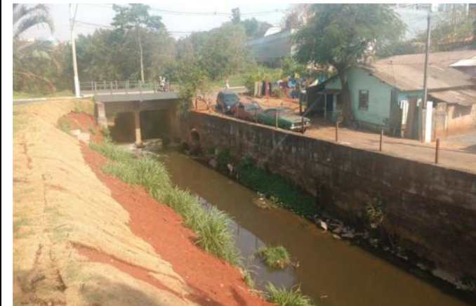
Foto 75: Detalhe da instabilidade de talude em trecho de canal do Córrego Manduca. Deslizamento de terra verificado. Rua Bento Correia Antunes, altura do número 230 (próximo à travessia 14). Coordenadas Geográficas: UTM 7.415.813 S; 208.569 E.
