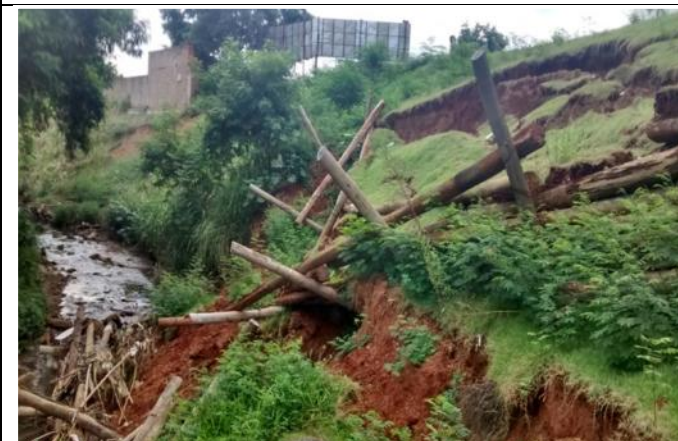
Foto 49: Vista geral do talude rompido. Nota-se que apesar de nem todo o talude haver desmoronado, as paliças restantes já demonstra sinais de movimentação e desgaste.
