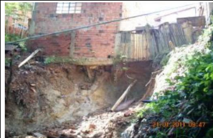
Foto 24: Córrego da Ponte Preta: Erosão atingindo uma residência, fundo da Rua Florindo Antunes Machado, Vila Esperança.
