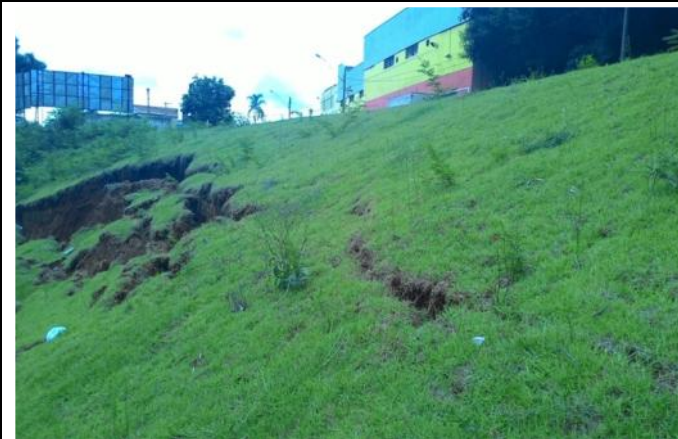
Foto 46: Vista geral da crista do talude rompido.
