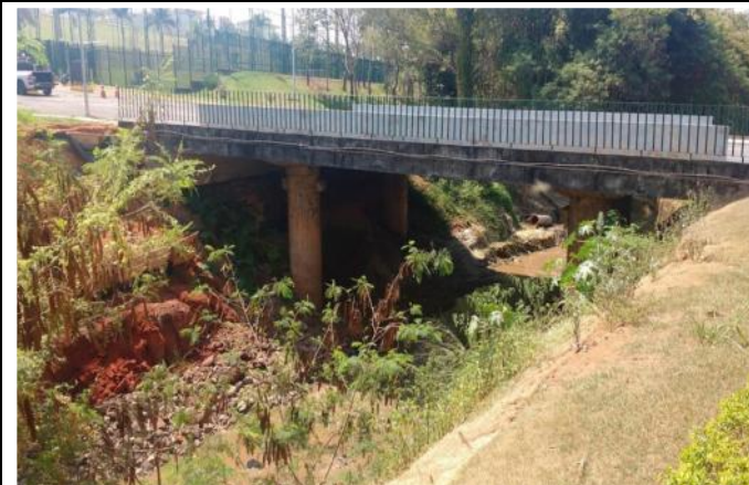
Foto 73: Ponte de concreto armado existente próxima à Rua Domingos Bassi (Travessia 17). Assoreamento das margens do canal. Coordenadas Geográficas: UTM 7.415.930 S; 209.366 E.
