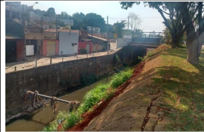
Foto 74: Trecho de canal com instabilidade de talude na margem direita do Córrego Manduca. Local: Rua Bento Correia Antunes, altura do número 583 (próximo à travessia 15). Coordenadas Geográficas: UTM 7.415.818 S; 208.647 E.
