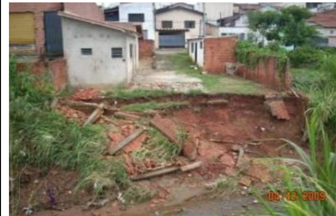
Foto 26: Marginal do Manduca: Forte erosão atingindo uma das residências da Rua São Martinho.
