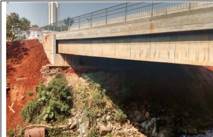
Foto 81: Detalhe da ponte em concreto armado recém-implantada sobre o Córrego Manduca - Rua Profa. Maria Aparecida Santi - Travessia 16. Verificada a necessidade de contenção de margens. Coordenadas Geográficas: UTM 7.415.894 S; 208.897 E.
