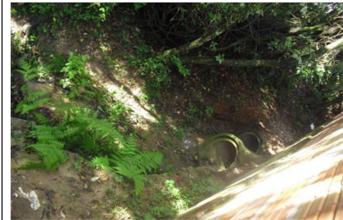
Foto 70: Erosão identificada no entorno de tubulação de lançamento de águas pluviais. Local: Rua Joaquim Toni. Coordenadas Geográficas: UTM 7.416.148 S; 209.968 E.
