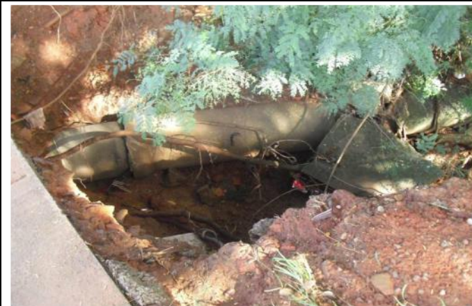
Foto 64: Assoreamento no entorno da tubulação de lançamento de rede de águas pluviais. Local: Rua João Batista Corrêa Campos. Coordenadas Geográficas: UTM 7.415.923 S; 209.441 E.
