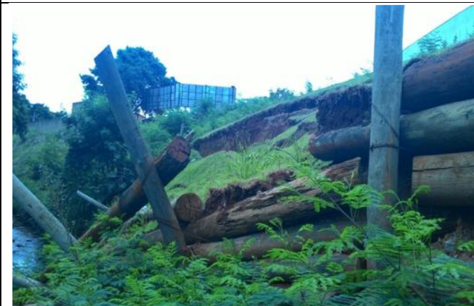
Foto 47: Vista geral do talude com paliçadas rompidas.
