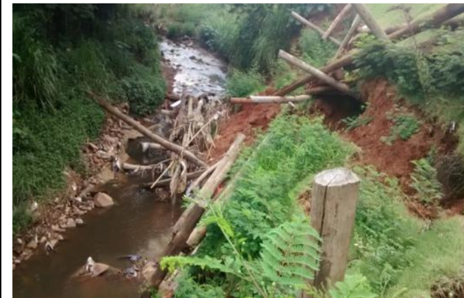
Foto 48: Vista geral do talude rompido.
