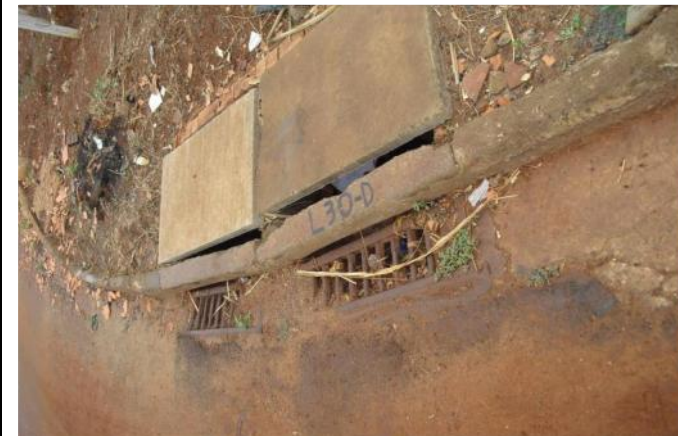
Foto 62: Boca de leão dupla existente. Identificado assoreamento do dispositivo de captação. Local: Rua José Orsi. Coordenadas Geográficas: UTM 7.417.575 S; 206.893 E.
