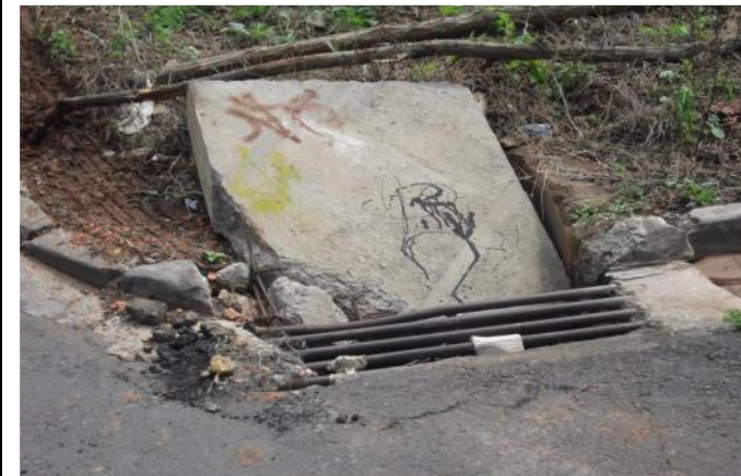
Foto 66: Avaria verificada em boca de leão simples existente. Local: Rua Prof. Oracy Gomes. Coordenadas Geográficas: UTM 7.414.127 S; 209.144 E.
