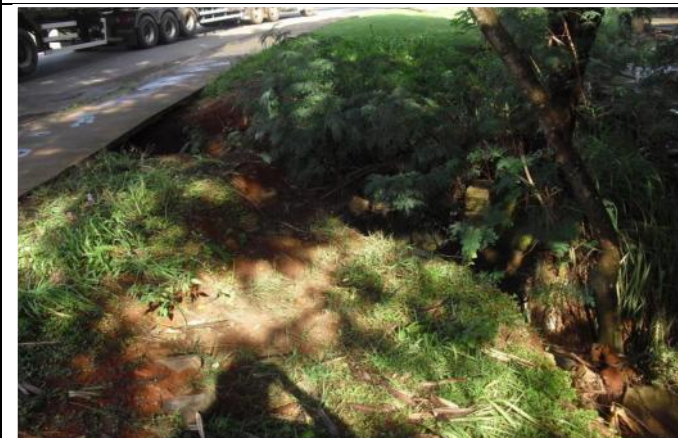
Foto 65: Assoreamento junto ao lançamento das águas pluviais. Local: Rua João Batista Corrêa Campos. Coordenadas Geográficas: UTM 7.415.923 S; 209.441 E.
