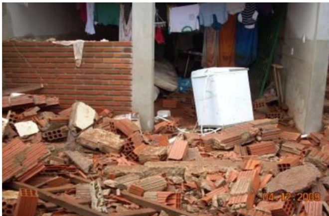
Foto 14: Centro, Rua XI de Agosto, alagamento de residência.
