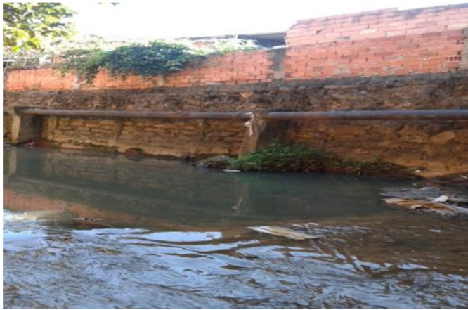
Foto 53: Trecho do Canal do Córrego da Ponte Preta. Em detalhe emissário de esgoto em ferro-fundido.
