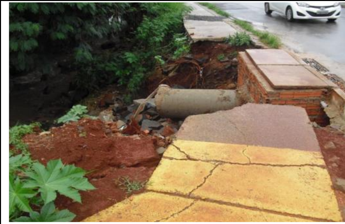
Foto 72: Erosão no Entorno de Ramal de Deságue de Águas Pluviais. Local: Rua Saladino Simões de Almeida. Coordenadas Geográficas: UTM 7.412.784 S; 207.753 E.
