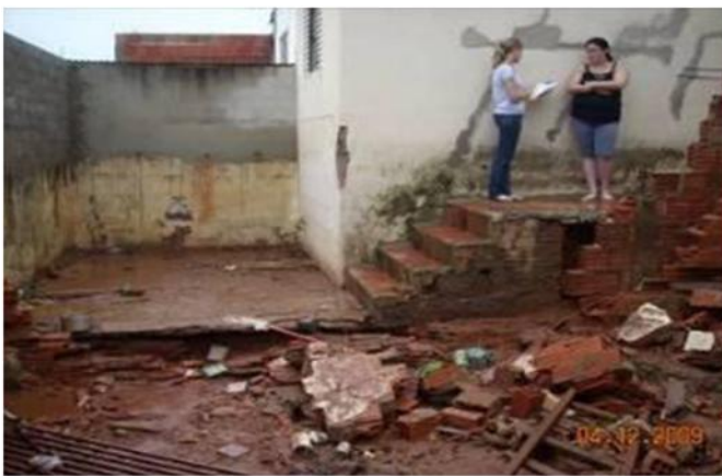
Foto 12: Alagamento de Residências na Rua Ind. Camilo Vanni, Jardim Palmira.
