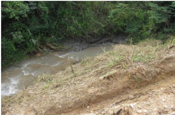
Foto 56: Processo erosivo às margens do Córrego da Ponte Preta.
