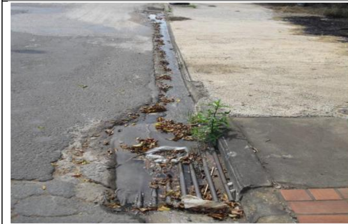
Foto 69: Boca de lobo simples existente. Verificado entupimento do dispositivo, devido a assoreamento por falta de limpeza e desobstrução. Local: Av. Jorn. Júlio de Mesquita Filho. Coordenada Geográfica: UTM 7.415.950 S; 209.939 E.
