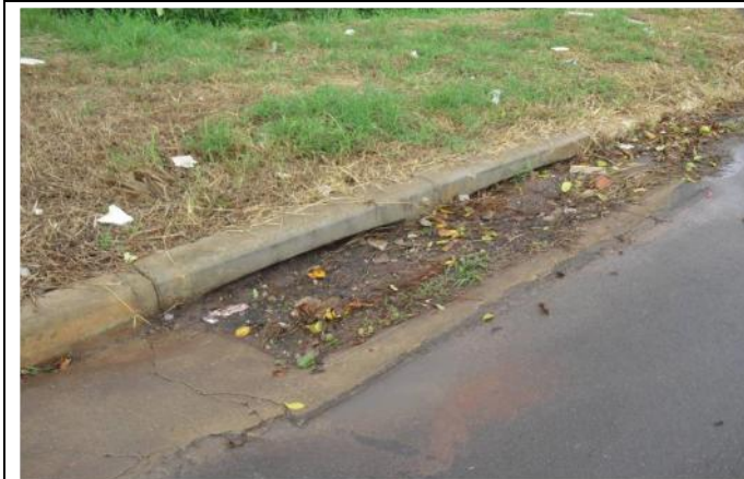
Foto 68: Boca de leão dupla existente. Dispositivo de captação completamente assoreado. Local: Rua Prof. Godói Moreira. Coordenadas Geográficas: UTM 7.415.319 S; 208.212 E.
