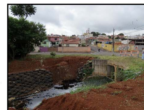
Vista geral de trecho afetado por inundações e da obra de contenção do talude marginal, por pneus, rompida em função da chuva do dia 26/01/15.
