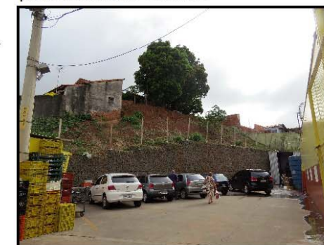
Muro de gabião, construído atrás de supermercado, para contenção do talude de corte.
