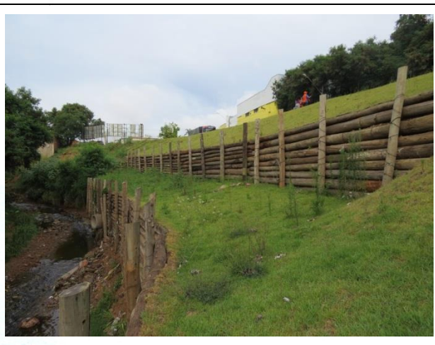
FOTO 10. Obra para contenção de talude e da margem esquerda do Rio Manduca. O trecho apresenta problemas de solapamento e de deslizamento.
