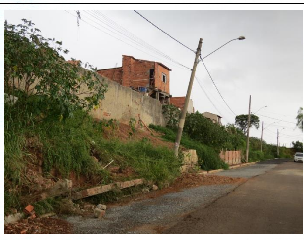
FOTO 4. Vista geral da área afetada por deslizamento. Notar o sobrado próximo ao topo do talude e os sinais de movimentação do terreno (ruptura de muro e poste inclinado).
