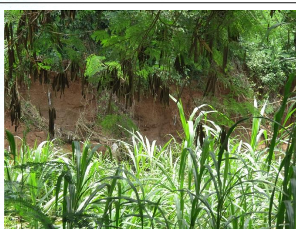
FOTO 40. Detalhe da erosão do talude marginal.
