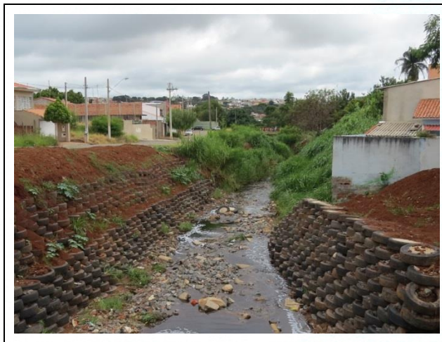
FOTO 31. Vista do talude marginal, com contenção de taludes por pneus. Observar o assoreamento por entulho
