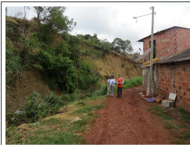
FOTO 19. Detalhe de moradia, situada na proximidade do córrego Ponte Preta, afetada pelas suas inundações
