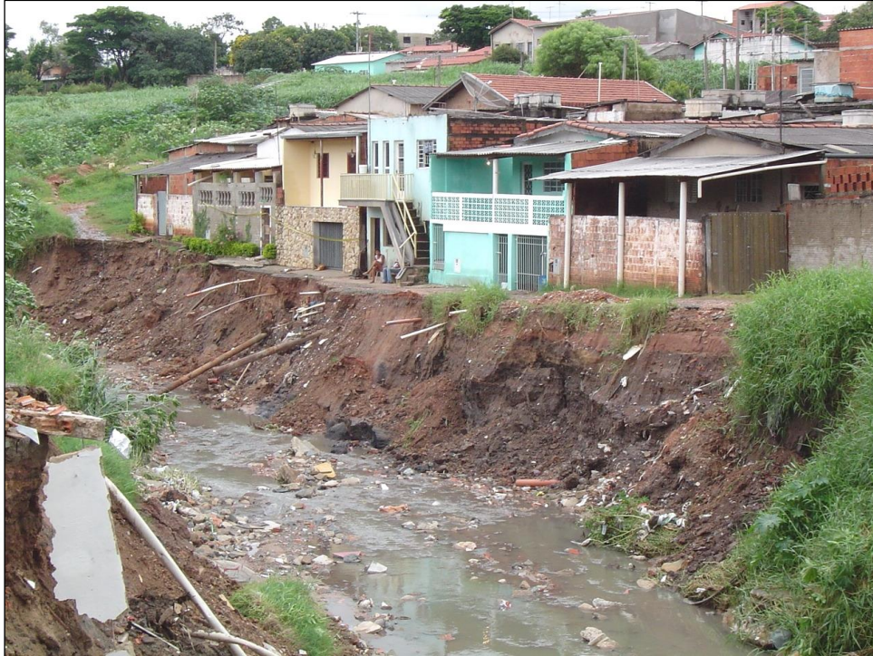
Figura 23 – Situação de risco associada a erosão e solapamento dos taludes marginais, com ocupação ribeirinha (Ministério das Cidades, Instituto de Pesquisas Tecnológicas do Estado de São Paulo – IPT, 2007).
