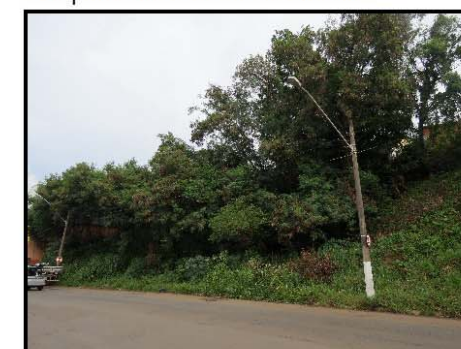
Vista do talude de corte com casas no topo. Nesse ponto, ocorrem lançamento de lixo e escavações irregulares no talude para retirada de material.
