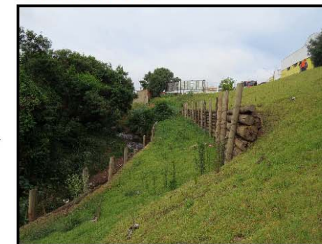
Obra para contenção de talude de aterro. O trecho apresenta problemas de solapamento e de deslizamento.
