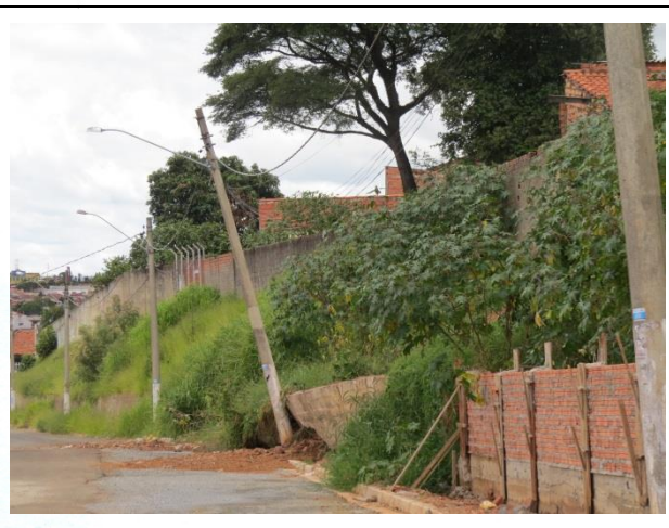
FOTO 2. Vista do muro e poste inclinado em função de deslizamento no talude de corte e aterro.
