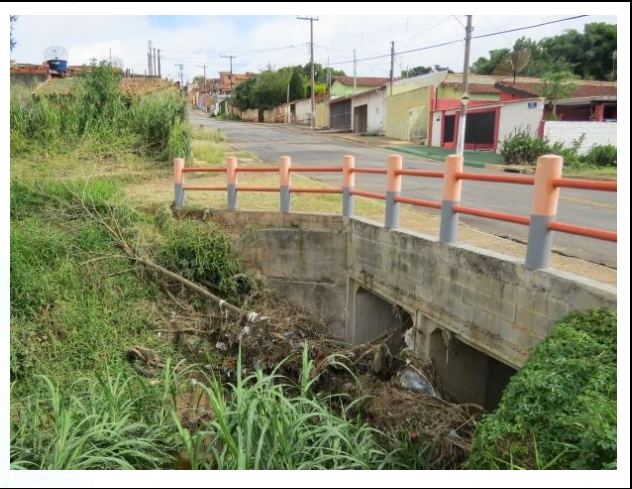
FOTO 34. Notar obstrução da seção de uma das pontes por galhos e lixo.
