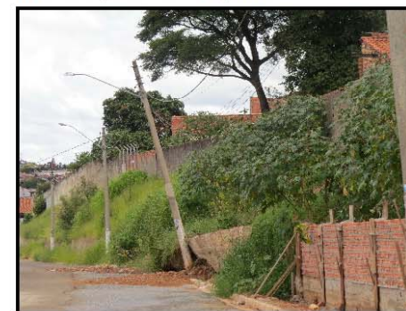
Vista do muro e poste inclinado em função de deslizamento no talude de corte e aterro.
