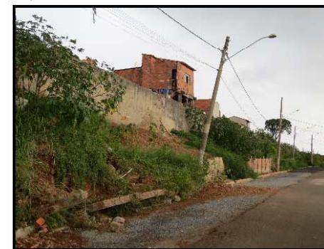
Vista geral da área afetada. Notar o sobrado no topo do talude, a ruptura de muro e o poste inclinado.
