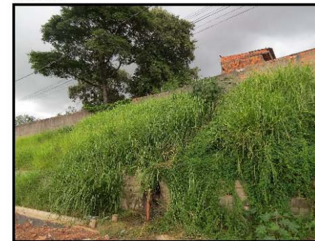
Vista geral do talude, com vazamento de esgoto na base do muro. Notar dimensões e proximidade da moradia.
