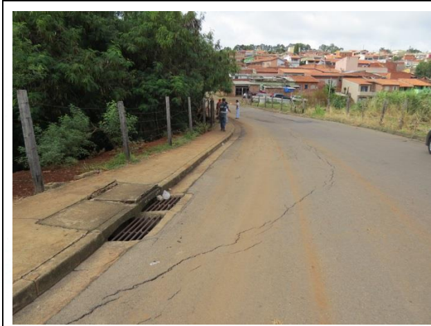
FOTO 17. Vista de trecho da Rua Natalino Turri. Notar trinca no pavimento, indicativa do processo de movimentação do terreno.
