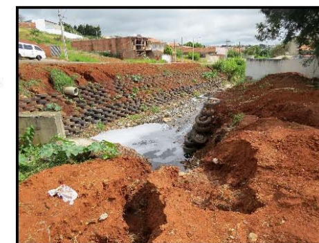
Vista de trecho do talude marginal, na altura do cruzamento da Rua São Martinho com a Rua Tamandaré.
