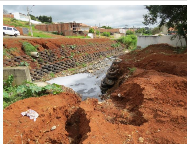
FOTO 30. Detalhe da erosão no talude marginal do ribeirão Manduca.
