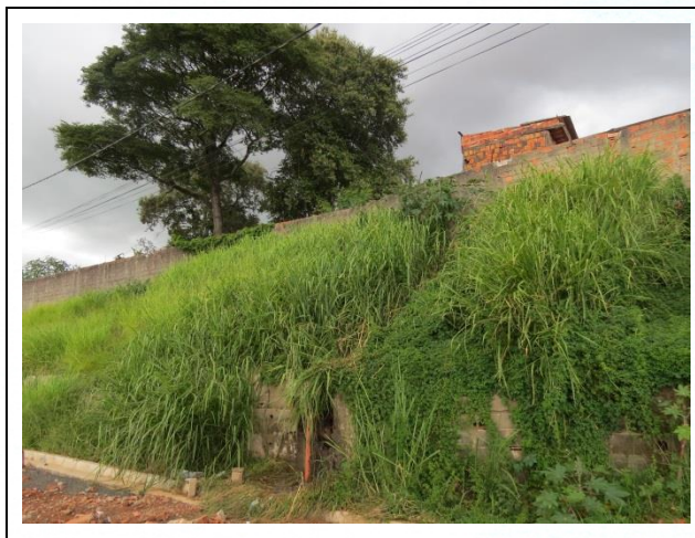
FOTO 3. Vista geral do talude. Nesse trecho ocorre vazamento de esgoto na base do muro. Notar dimensões e proximidade da moradia.
