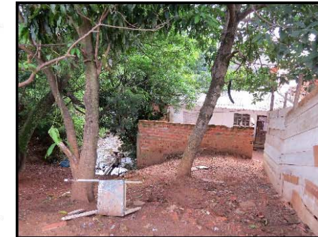
Vista de moradias localizadas na margem direita do córrego Ponte Preta. Nesse trecho, ocorrem processos erosivos e solapamentos de margem.
