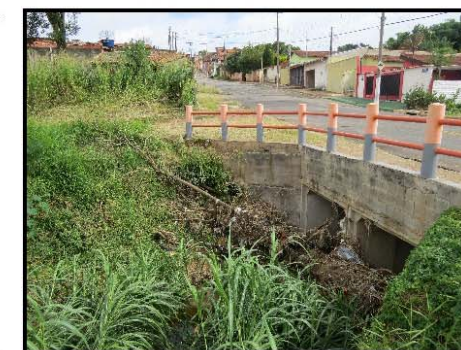
Notar obstrução da seção da ponte por galhos.
